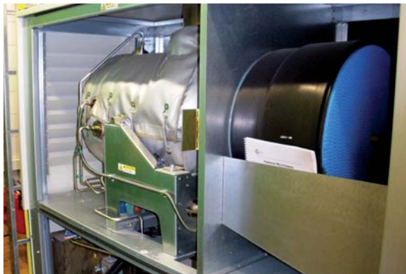
Bild 20: Mikrogasturbine mit einer elektrischen Leistung von 65 kW
