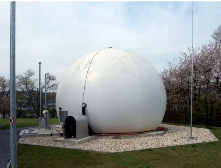
Bild 16: Externer Doppelmembrangasspeicher auf der Kläranlage Linz-Unkel (Jakob, Siekmann 2010)
