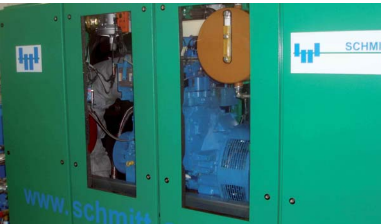
Bild 19: BHKW-Anlage mit einer elektrischen Leistung von 50 kW
