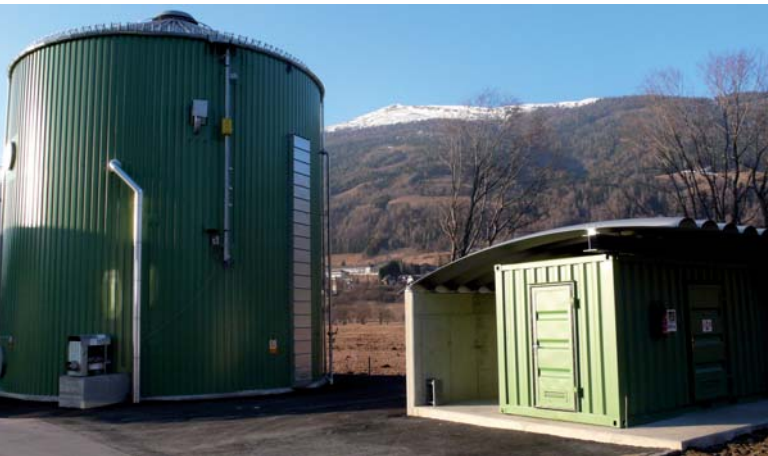
Bild 12: Faulbehälter mit integriertem Gasraum in Stahlbauweise mit BHKW in Containeraufstellung
